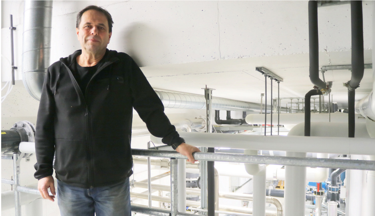
Alajärven uimahallin hallimestari Olli Ojanperä kertoo, että uimahallin tekniikka sijaitsee rakennuksen alakerrassa, jossa sijaitseekin melkoinen hermokeskus!
