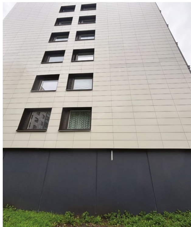
📍 Kylmäaineputket ja kondenssiveden poistot kulkevat julkisivulevyjen alla, jolloin ratkaisu on myös ulkonäöltään huomaamaton.
