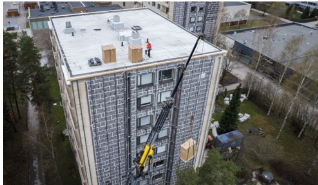
🔗 VRF-järjestelmiä on käytetty pitkään liikekiinteistöissä ja hotelleissa. Runosmäessä tekniikka tuodaan ensimmäistä kertaa laajasti suomalaisiin kerrostaloasuntoihin. Kuva: JR Lämpötekniikka
