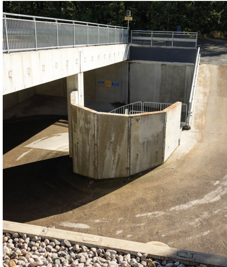
☑️ Kakolan Keidas II:n parkkihalliin johtavan ajoluiskan talvikunnossapidon kustannusten jyvittäminen on tuottanut haasteita.
